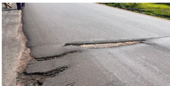
Fig. 1 : Route érodée en raison de la mauvaise qualité de la livraison (AMG 2026)
